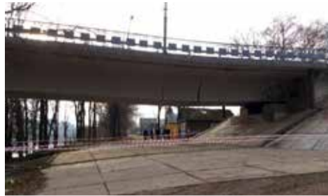
Просевшее пролетное строение моста в пролете №5-6
